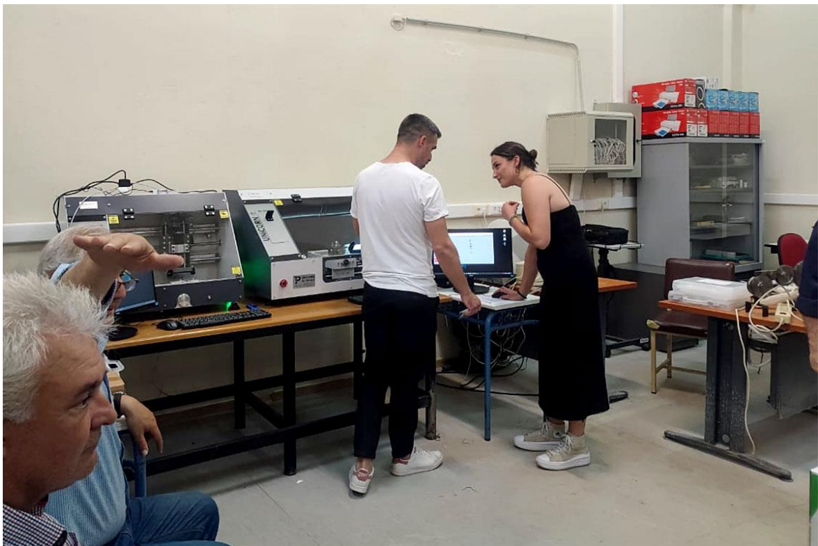
Εικόνα 4 Εγκατάσταση εργαστηριακού εξοπλισμού Μηχανολογίας στην Καρδίτσα
